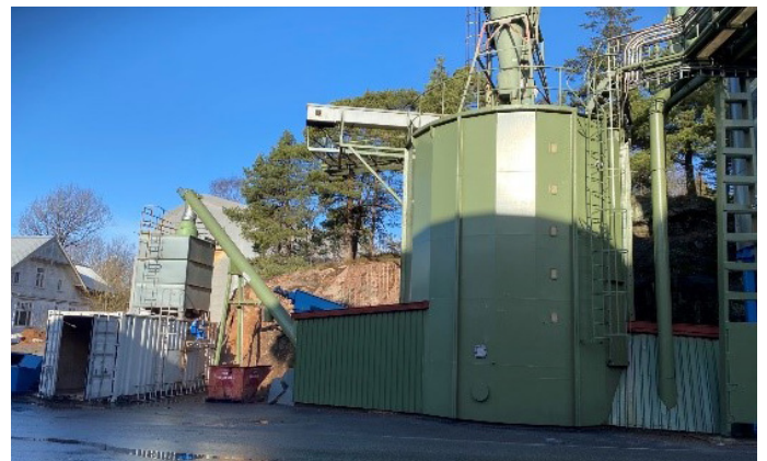
Bildet viser støvsilo med transportsystem som er modifisert og som har medført redusert mengde briketter til forbrenning.
