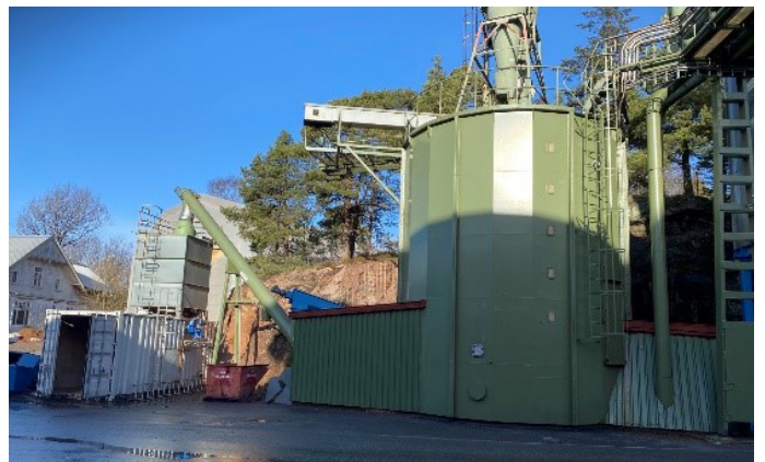
Bildet viser støvsilo med transportsystem som er modifisert og som har medført redusert mengde briketter til forbrenning.
