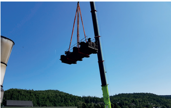
Hele pressa ble løftet ut gjennom taket av en stor mobilkran. På bildet vises toppstykket av pressa som veier over 20 tonn.
